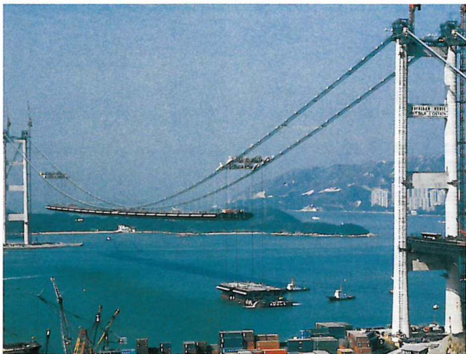
Erection of deck sections of Tsing Ma Bridge. 青馬大橋的橋面鋪設工程。
